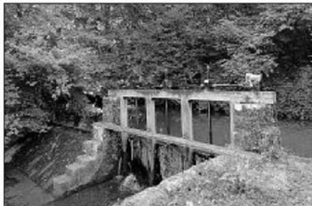
L'ouverture des vannes pose notamment problème.
